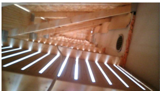
Kuva. Räystääson telon palokatko edellyttää aikataulun onnistumista, liian myöhään toteutustila on liian ahdas rakentamista varten, J-P Laakso, SPPL
