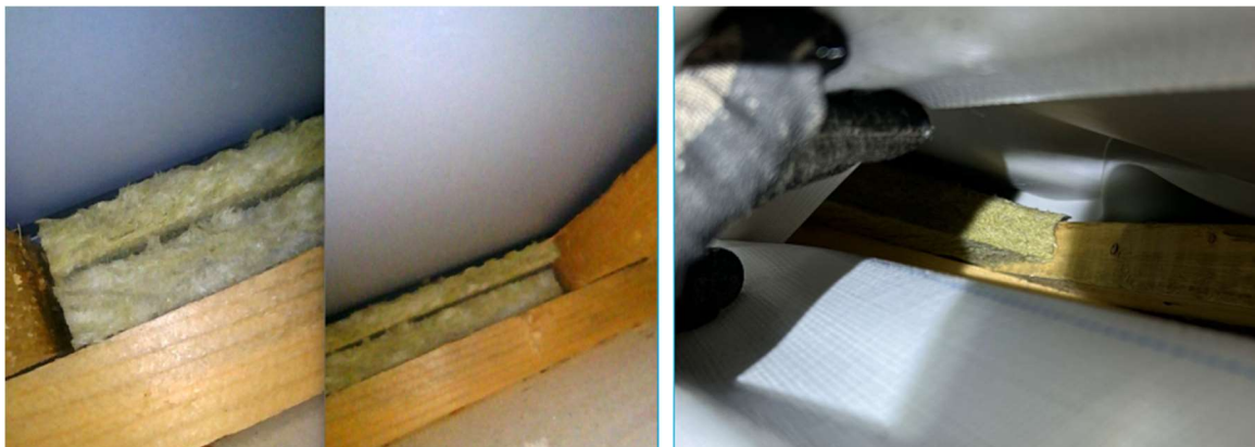
Kuva: Yläpohjan osastoivan seinän tiiveyspuutteita vesikateliitoksessa, J-P Laakso, SPPL
