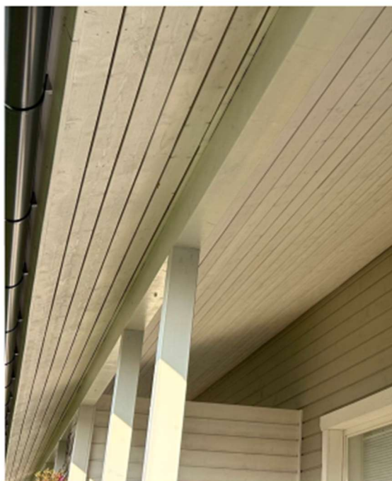
KESKEN: Kuva. Terassin osinjakava seinä on kokonaan auki yläosasta
